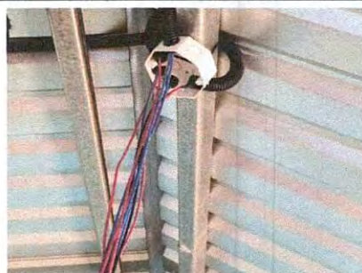
Foto 4: Institucion de sistema electrico
