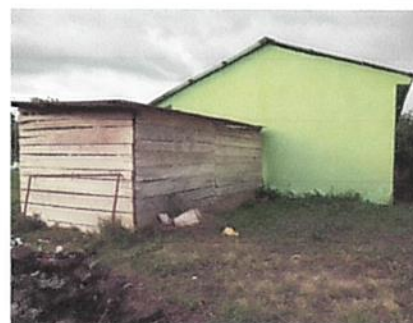
Foto 4: Alisado en Muro
