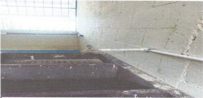
FOTO 7: RED DE AGUA POTABLE
