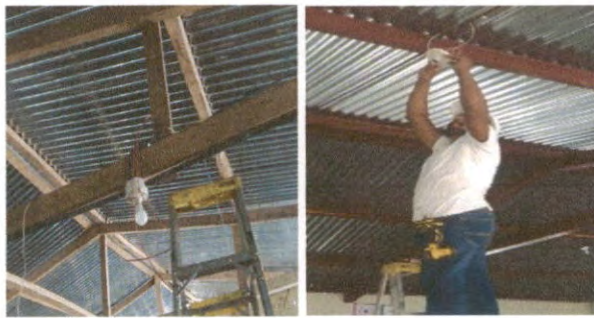
Sustitucion de focos ahorradores
