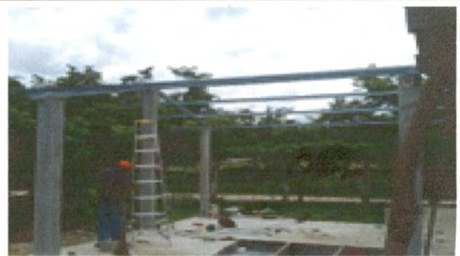
SUSTITUCIÓN DE SOPORTE DE METAL POR METAL
