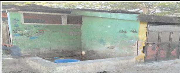
Foto 7: BAÑOS EN SUS LAVAMOS NO TIENEN AZULEJOS
