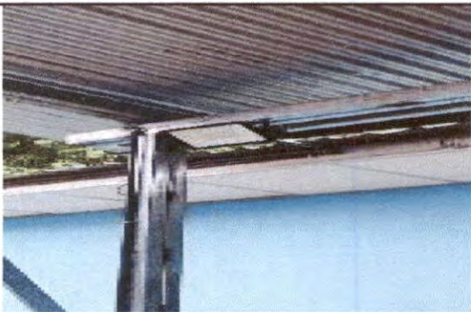
SUSTITUCIÓN DE LAMPARAS TIPO LED
