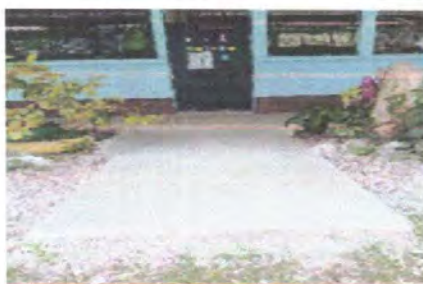
Foto 15: TORTA DE CONCRETO ENFRENTA DE AULAS.
