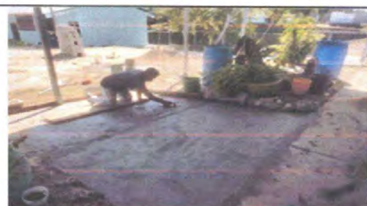
Foto15: TORTA DE CONCRETO FRENTE A AULAS.
