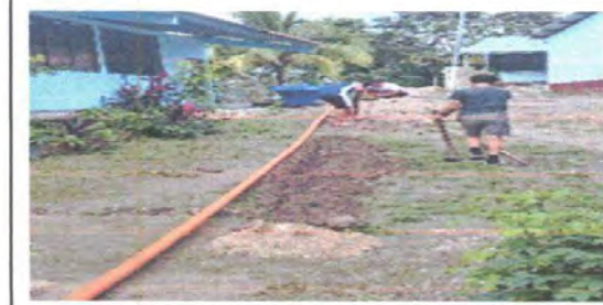
Foto 18. Tebería de PVC de aguas negras
