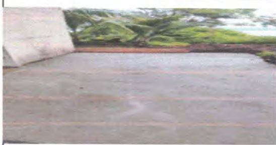
Foto 19: TORTA DE CONCRETO EN PARTE DE ALADO DE COCINA
