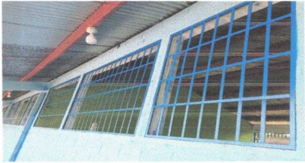
Foto 2: Ventanas en mal estado / Balcones de metal
