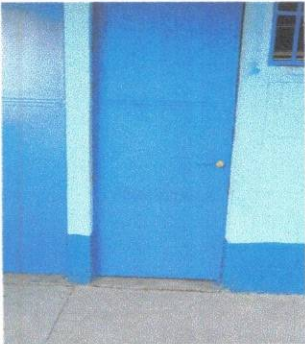
Foto1: Puertas en mal estado/ Puertas de metal
