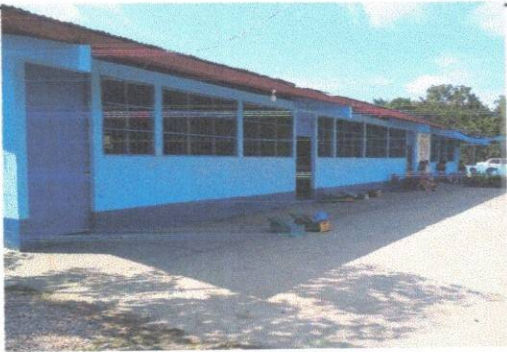
Foto 3: Pintura en mal estado / Pintura de muros exterior e interior
