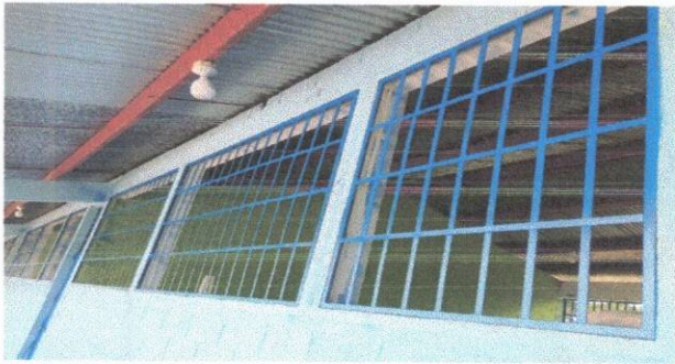
Foto 2: Ventanas en mal estado / Balcones de metal
