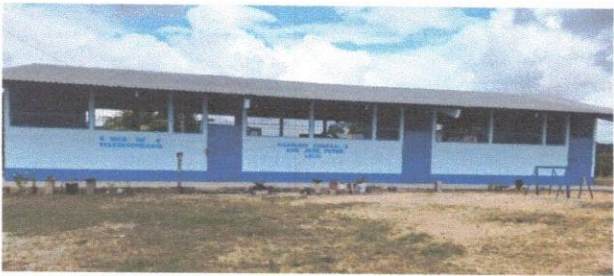
Foto 3: Pintura en mal estado / Pintura de muros exterior e interior
