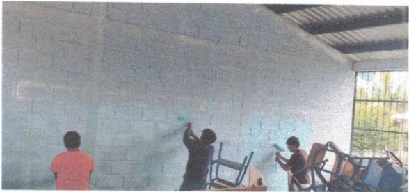
Foto 3: Pintura en mal estado / Pintura de muros exterior e interior
