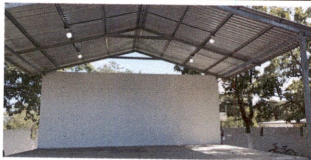
Foto 3: instalación eléctrica en el escenario
