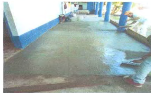
Foto 16: TORTA DE CONCRETO
