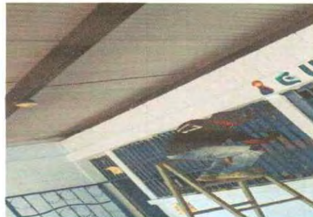
Foto 20: ESTRUCTURA DE METAL EN VENTANA
