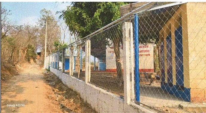
Foto 4: MALLA METALICA MEJORADA
