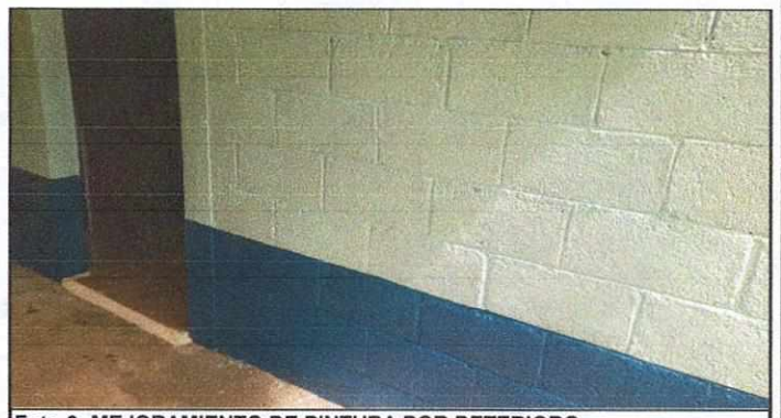
Foto 6: MEJORAMIENTO DE PINTURA POR DETERIORO
