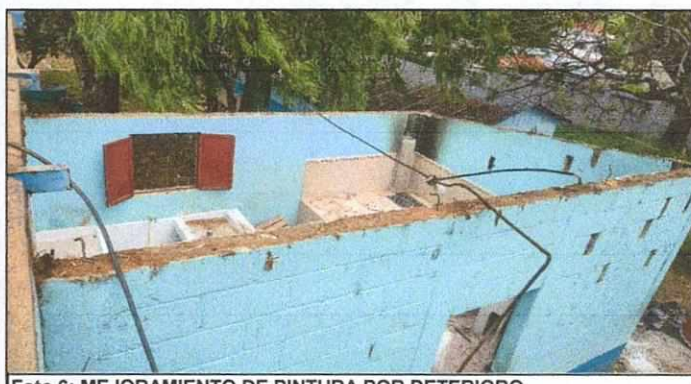
Foto 6: MEJORAMIENTO DE PINTURA POR DETERIORO
