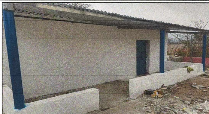
FOTO 2: VISTA LATERAL IZQUIERDA DE COCINA MEJORADA
