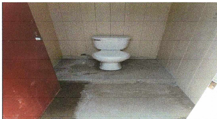
Foto 4: TAZAS EN SERVICIOS SANITARIOS A INSTALARDO Y CAMBIADO
