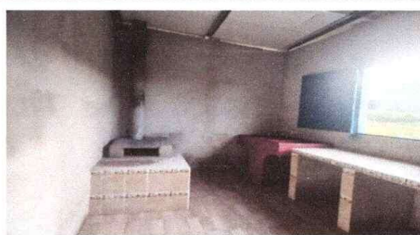
Foto 2: SE SOLICITA CAMBIO DE PLANCHA PARA COCINAR.
