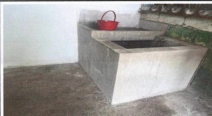
Foto 3: MEJORAMIENTO DE PILAS CON SUS GRIFOS
