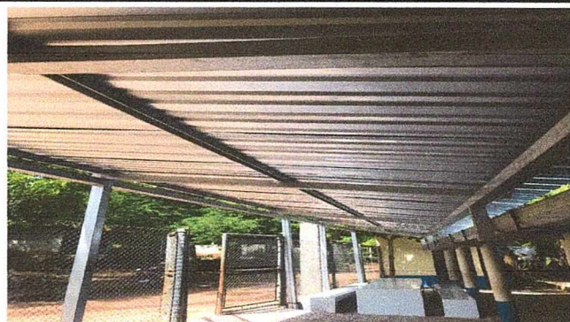
Foto1: SE COLOCO TECHO AL PATIO YA QUE NO CONTABAN CON ELLO.
