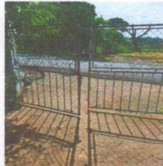
Foto 8: Portón de malla y tubo metálico en mal estado para mejorar con lámina de metal.
