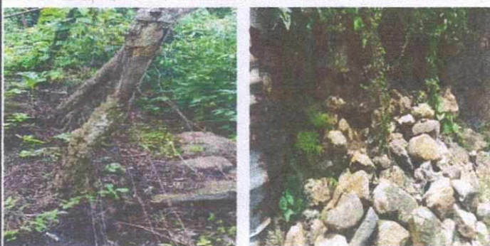
Foto 4: Muro de contención incompleto y en su mayoría colapsado para mejorar con block, cemento y malla metálica.
