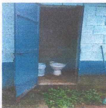
Foto 4: Sanitario de cerámica dañado e incompleto para sustitución por sanitario completo nuevo lavable (incluyendo accesorios)
