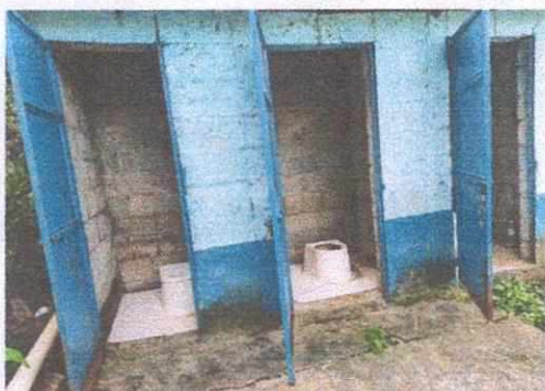
Foto 3: Sanitarios tipo letrina no adecuados y dañados a sustituir por sanitarios de cerámica lavables.
