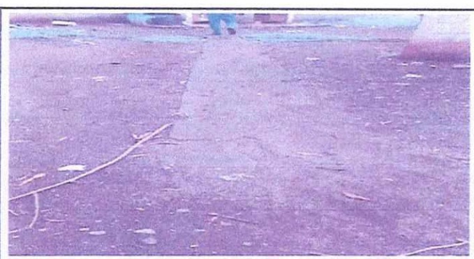
Foto 6: ENTORTADO HACIA LOS SANITARIOS
