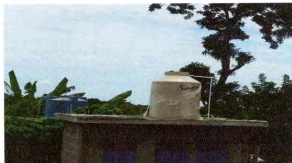
Foto 08: Instalación finalizada de tinaco de agua y sus accesorios para suministrar a servicios sanitarios.
