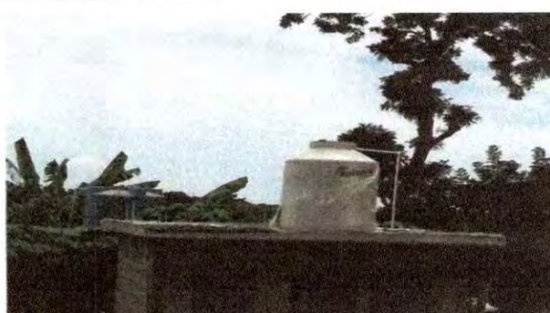
Foto 08: Instalación finalizada de tinaco de agua y sus accesorios para suministrar a servicios sanitarios.
