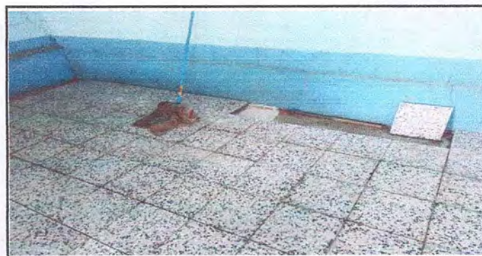
Foto 6: Piso de módulo de aula 2
