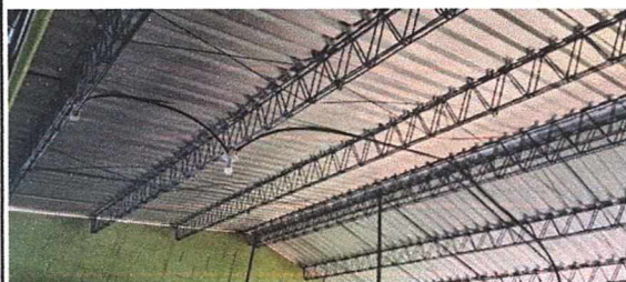
Foto 2: Sustrucción de lámina dañada por lamina troquelada calibre 26 de aulas
