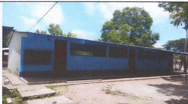
Foto1: MEJORAMIENTO DE PARED EN MAL ESTADO
