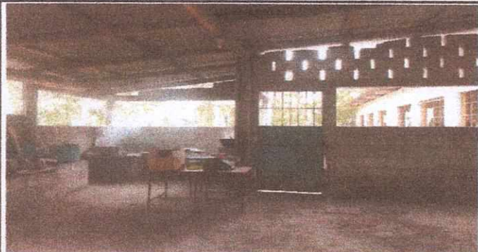
Foto1: Mejoramiento de piso en mal estado y polleton
