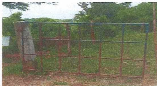
Foto 8: Portón de acceso principal dañado a mejorar con malla metálica.
