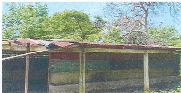
Foto 2: Lámina en mal estado para sustitución por lámina troquelada calibre 26 en cocina.
