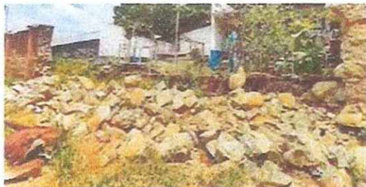
Foto 7: Muro perimetral dañado a mejorar y ampliar con block, cemento y malla metálica.
