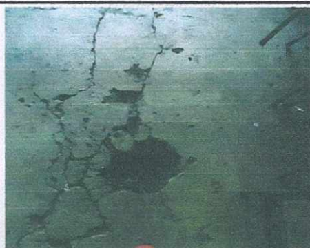
Foto 5: Rajaduras y grietas en el suelo de las aulas
