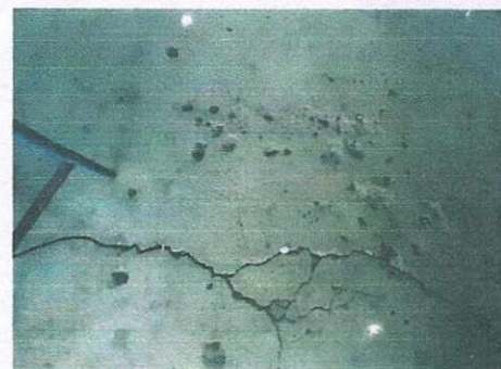
Foto 6: Rajaduras y grietas, así como perforaciones al entornado de todas las aulas
