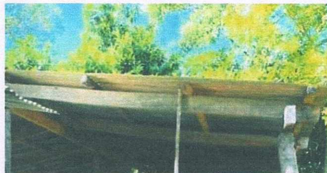
Foto 2: Techo de la cocina, con estructura de madera y láminas dañadas, en donde se filtra el agua y se corre el riesgo de que la estructura ceda por estar podrida
