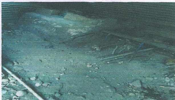
Foto 3: Polletón de barro, es desnivel y sin entortado, dificultando el proceso de elaboración de alimentos
