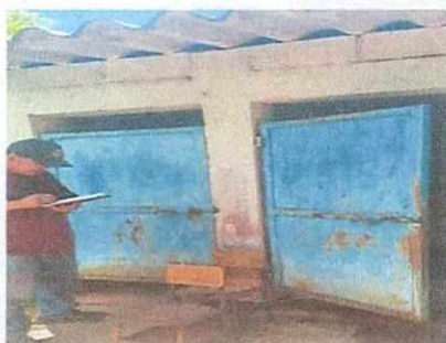
Foto 11: Puertas de metal en sanitarios dañados a reparar
