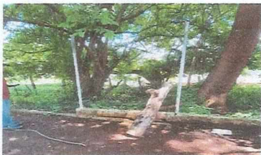
Foto 13: Reparación de muro perimetral en mal estado
