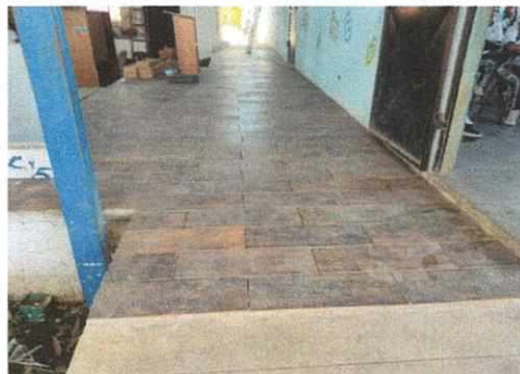
Foto 2: piso en corredor
