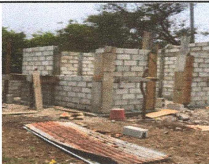
Foto 3: Se necesita pared de block mejoramiento de polleton e instalación de plancha.
