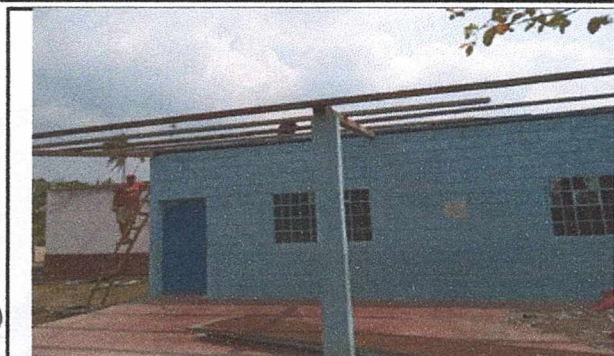
Foto 1: Se necesita sustitución de estructura metálica, lámina troquelada.
