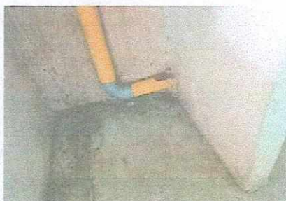
red de agua potable cocina
