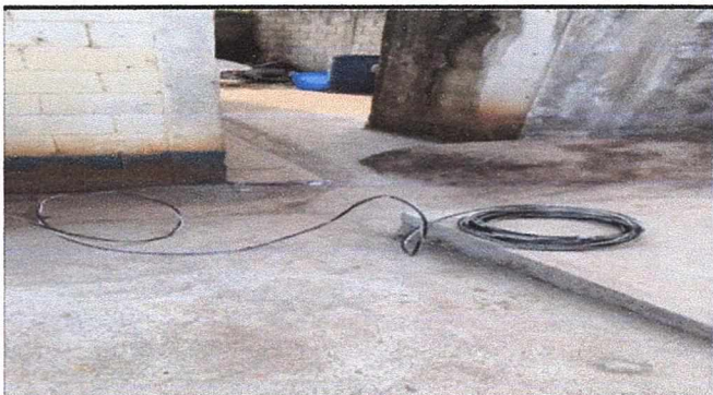
Energia Electrica: Matenimiento del sisema de energia electrica general
