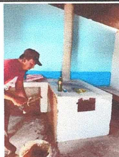
Cambio de estufa de leña con chimenea
