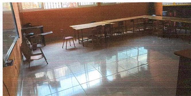
PISO EN MAL ESTADO
