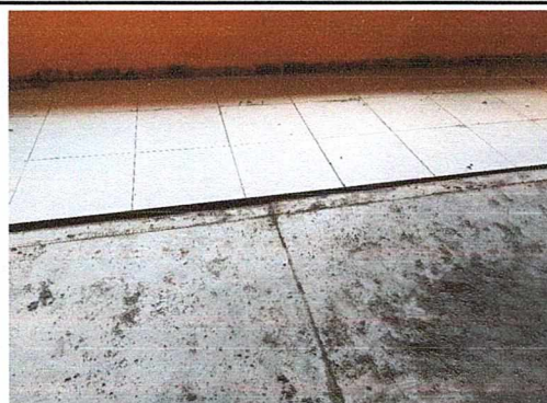
PISO EN MAL ESTADO
