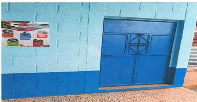
PUERTAS DETERIORADAS, NECESITAN MANTENIMIENTO
