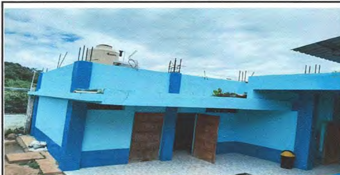
DETERIORO DE PINTURA NECESITA SER RENOVADA
