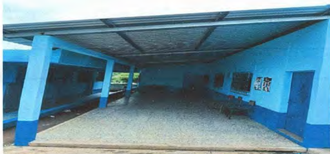
DETERIORO DE PINTURA NECESITA SER RENOVADA
