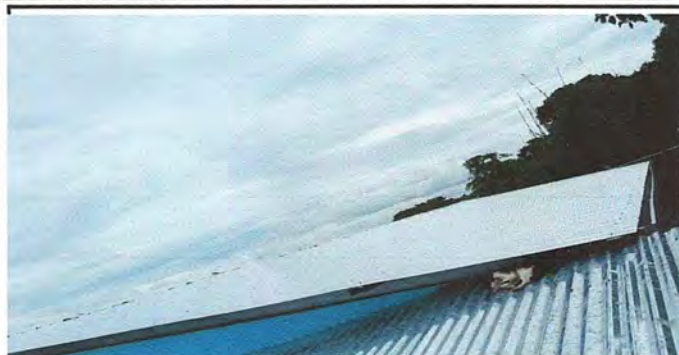
LAMINA EN MAL ESTADO, SE NECESITA CAMBIO
