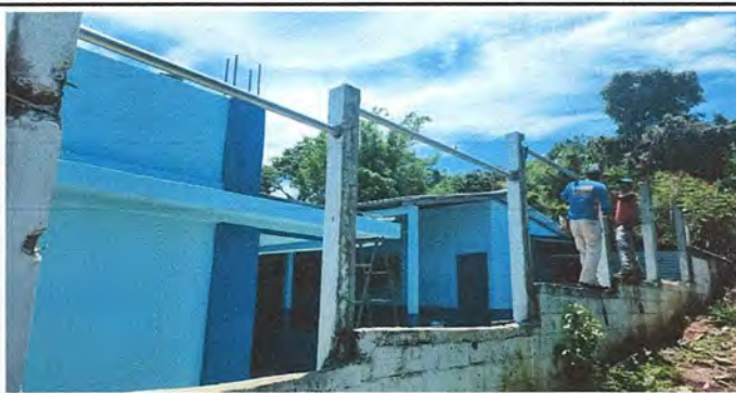
DETERIORO DE PINTURA NECESITA SER RENOVADA
