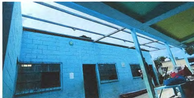
PUERTAS DETERIORADAS, NECESITAN MANTENIMIENTO
