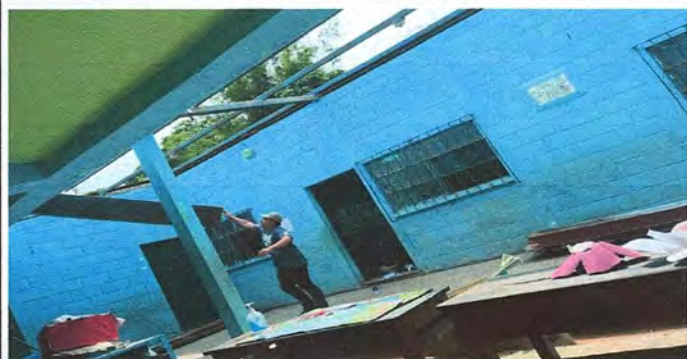
LAMINA EN MAL ESTADO, SE NECESITA CAMBIO
