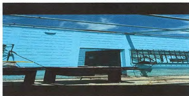
PUERTAS DETERIORADAS, NECESITAN MANTENIMIENTO
