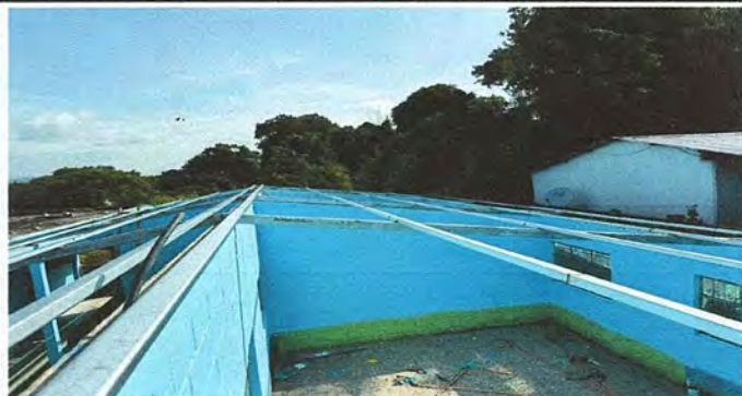
ESTRUCTURA METALICA EN MAL ESTADO
