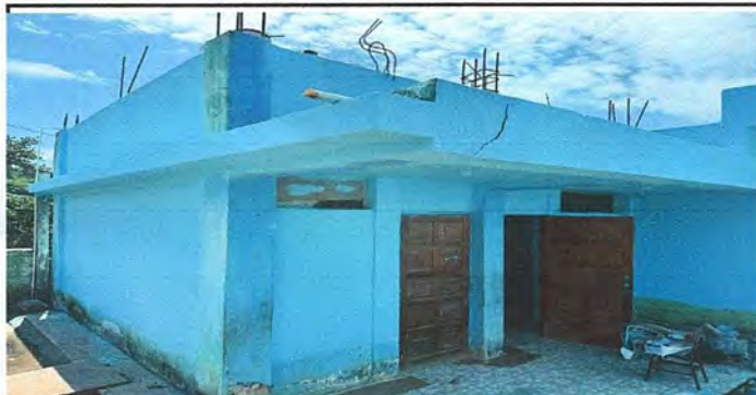
DETERIORO DE PINTURA NECESITA SER RENOVADA
