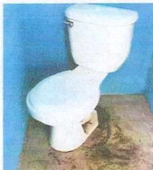
Foto 1: Baños mal instalados, sin alimentación de agua para su correcto funcionamiento.
