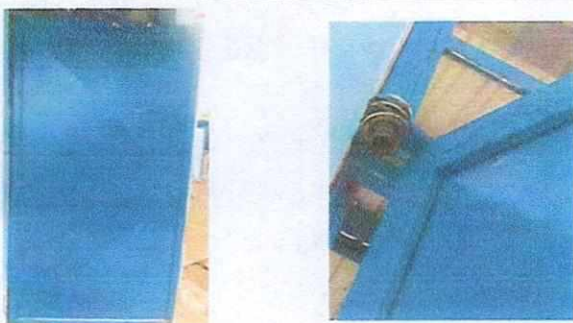
Foto 3: Puertas en mal estado, se procederá a hacer el correcto anclaje al vano, corregir el sistema de pivotes y pintarlas con pintura anticorrosiva.
