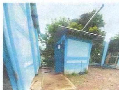
Foto 4: Techo de baños muy pequeño, se procederá a hacer una ampliación para que los alumnos no se expongan en épocas de lluvia.
