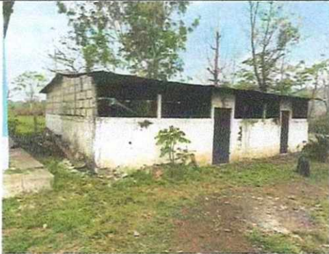
Foto 1: Módulo de aulas, reforzar con columnas, demoler y rehacer el mojinete, fundicion de saleras sillar corona y mojinete.
