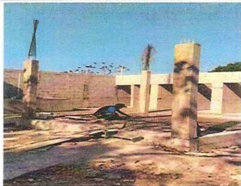
Foto 1: Baños sin techo, puertas, tazas, piso, azulejo y repello
