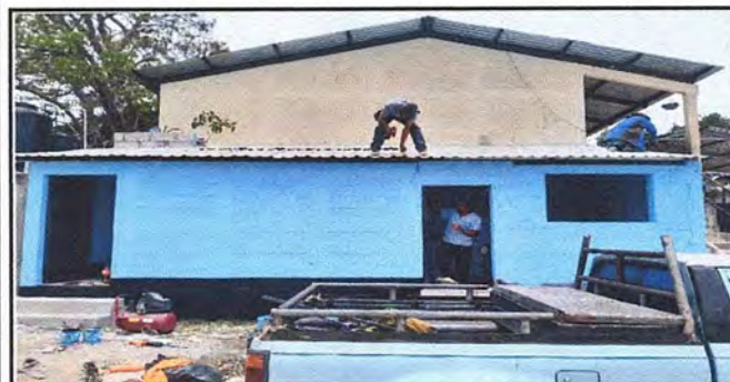
Foto 5: Pintado en paredes de baños y cocina. Cubierta de lámina troquelada en área de cocina.
