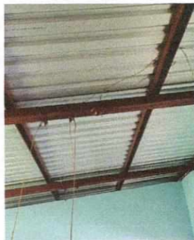
MATERIAL ELÉCTRICO ACTUAL
