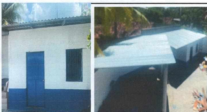
Foto 3. Reparacion o Sustitucion de puerta en cocina. Puerta en mal estado se cambia por una con chap y remodelacion de cocina
