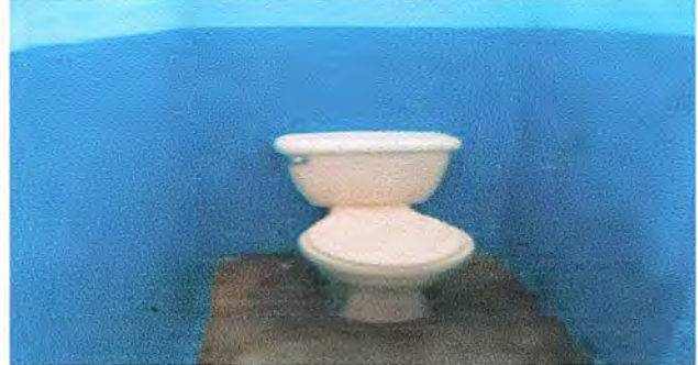
Foto 6: Servicios sanitarios y sus accesorios
