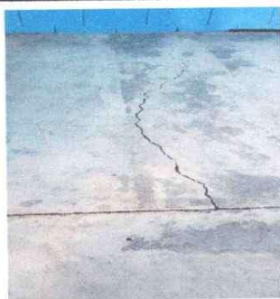
Foto 5: torta de cemento en mal estado
