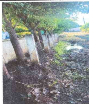
Foto 2: muro perimetral en mal estado
