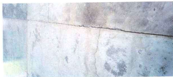
Foto 6: torta de cemento en mal estado
