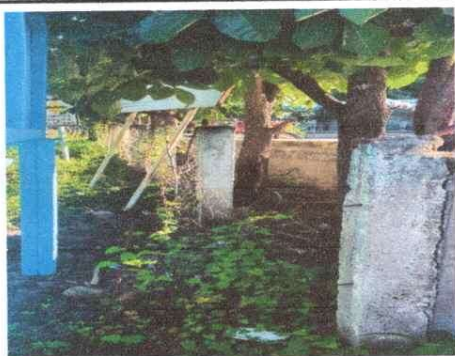
Foto 3: muro perimetral en mal estado
