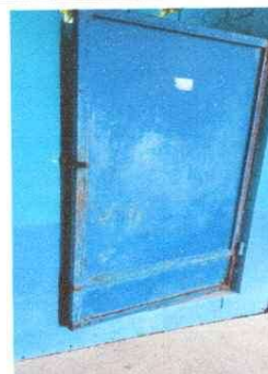
Foto 4: puertas de baños en mal estado
