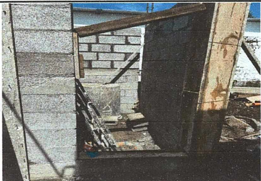
Foto 3: Puesta en mal estado, se sustituirá por más seguridad.
