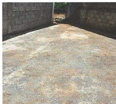
Torta de entrada reparada
